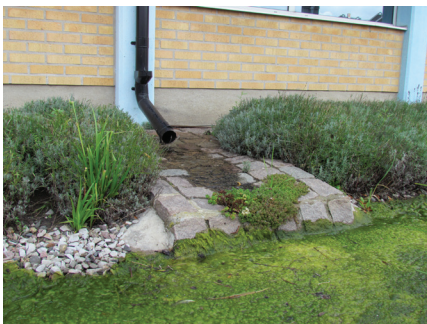
Figur 25: Regnvand ledes i en tæt rende bort fra huset til nedsivning i græsplænen. Foto Orbicon, Augustenborg, Malmø.
